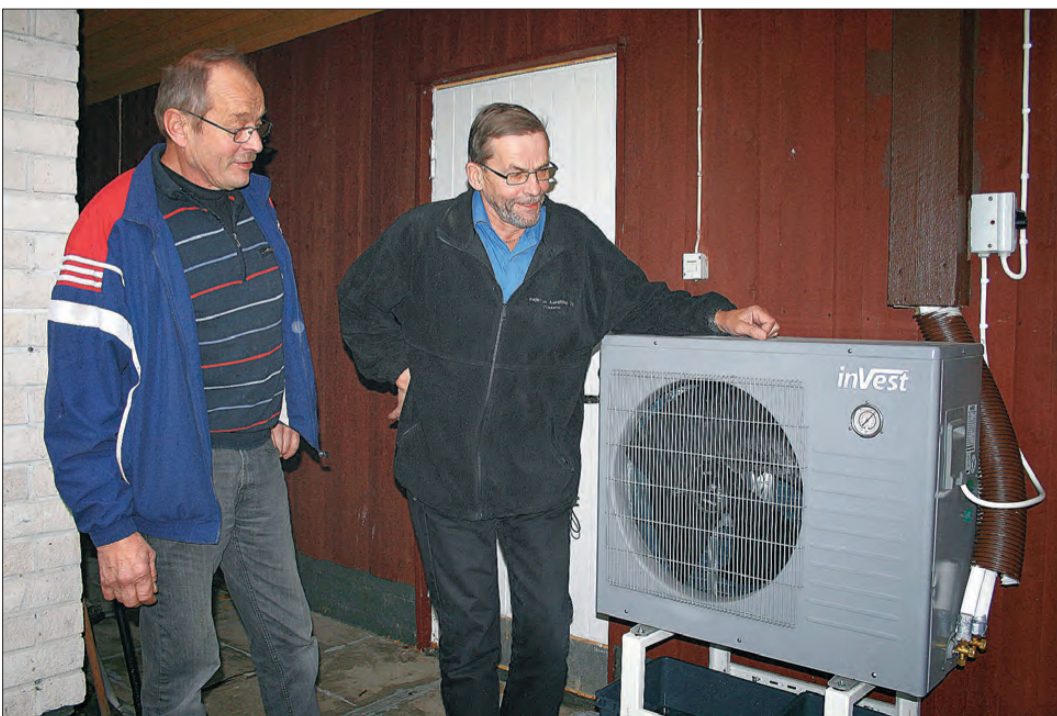
Jörgen Holm och Jörgen Granholm med värmeväxlaren som tar värme ur luften och använder den för att värma gas som i sin tur hettar upp vattnet som cirkulerar runt i husets batterier. Värmeväxlaren kan kopplas ihop med befintliga värmesystem.
