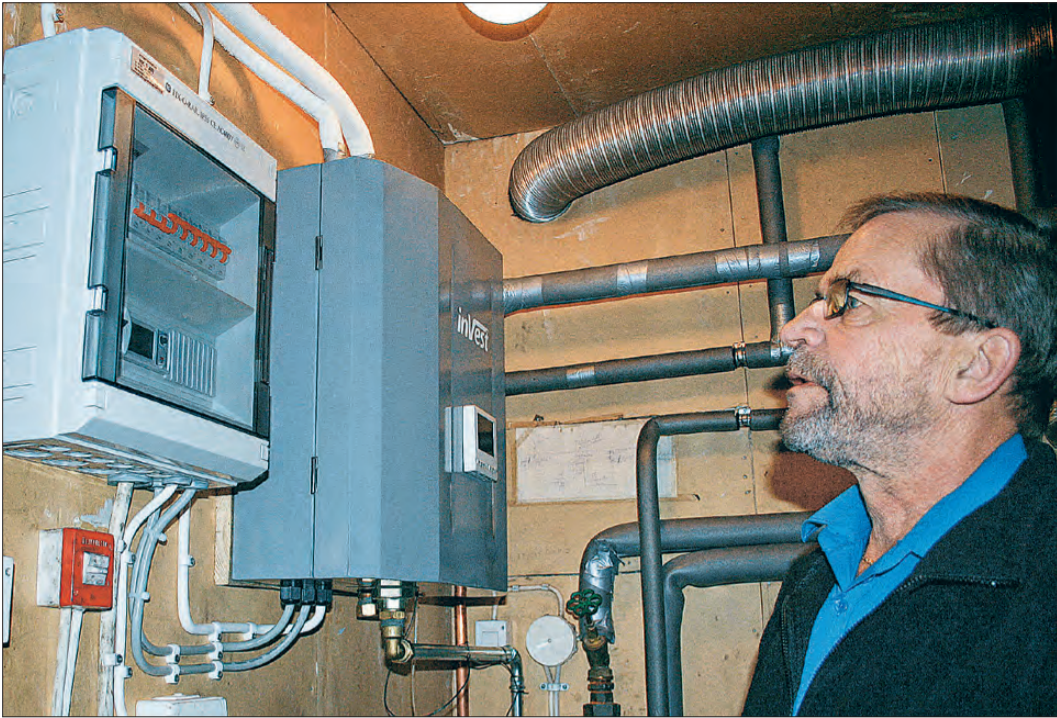
Jörgen Granholm tar sig en titt på mätartavlan som finns på väggen i pannrummet. När det blir smällkallt mitt i vintern kopplas oljepannan på, men så länge det är varmare än -20 grader utomhus, behövs ingen tilläggsenergi.
